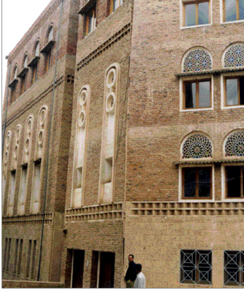
■ مبنى المركز بدون لوحة تعريفية
